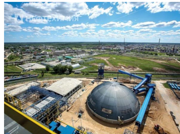
установка замедленного коксования нефтяных остатков в ОАО "Нафтан"
